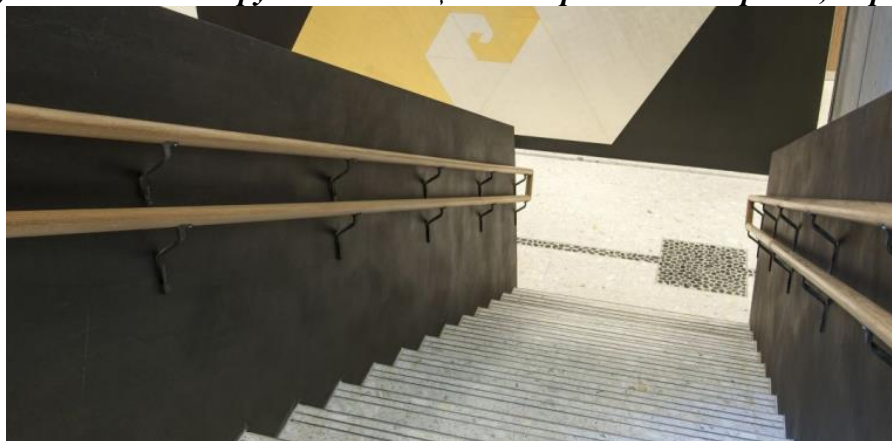
Рисунок 8. Оборудованная двойными перилами лестница
